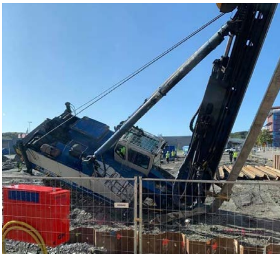
Figur 2:5 (Ovan t.v.) Bärighetsbrott under larv, eventuellt på grund av att man tidigare utfört en provgrop i detta läge som inte återfyllts och packats korrekt. Hög tyngdpunkt av påle och hejare.
