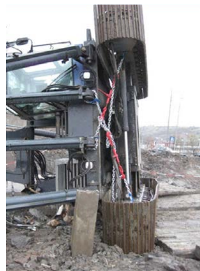
Figur 2:1 Jorden utgjordes av lera och arbetsplattformen av en fyllning på ca 0,4–0,5 m med stockmattor. Maskinen stod för nära kanten av stockmattorna. I anslutning till arbetsplattformen hade man tagit ett antal lerproppar med augerborr innan pålningen utfördes.
