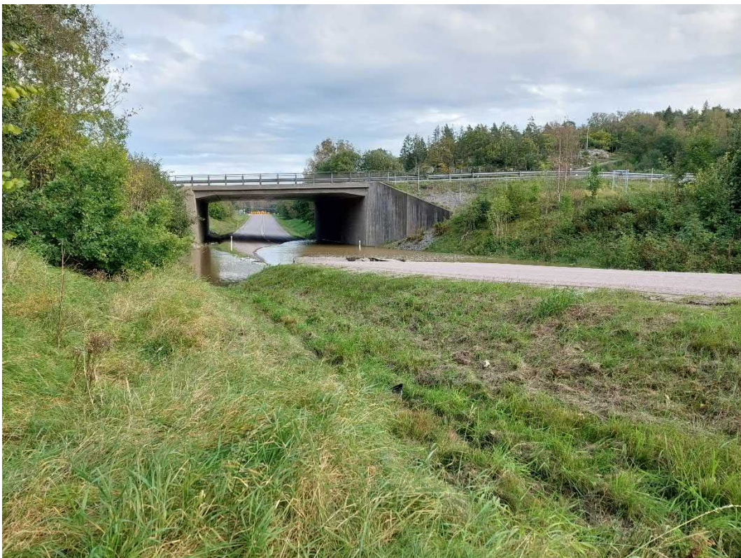
Foto 6. Vattensamling vägport Ucklumsvägen (under E6). Fotoriktning: Ö. Foto: SGI.
