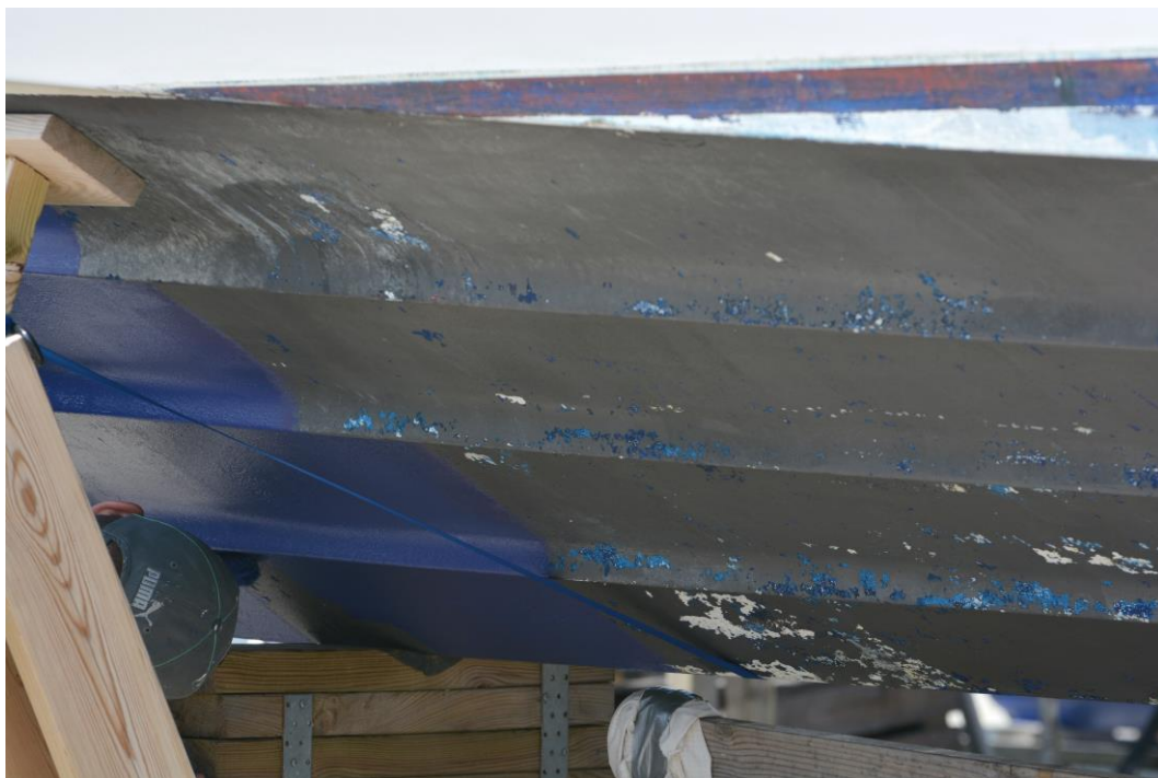
Figur 2-1 Båtskrov med gamla färgrester. Foto: Helena Branzén, SGI.
